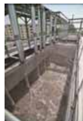
排水処理プラント
