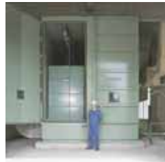
ボエフ脱臭塔
