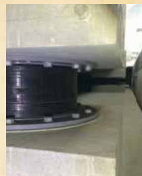
冷蔵庫棟の免震装置
