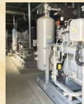
自然冷媒冷凍装置
