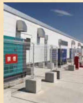
非常用発電装置
