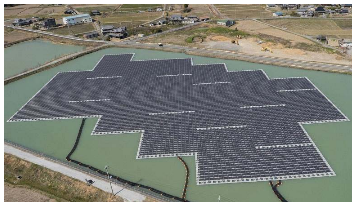
兵庫・高岡西水上メガソーラー発電所 （加東市 西平池 約 1.7MW）
