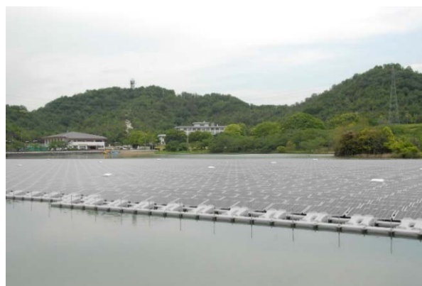
兵庫・加西市逆池水上メガソーラー発電所 （約 2.3MW）
