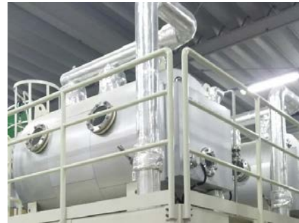
蒸発濃縮装置で洗浄廃液を減容化
