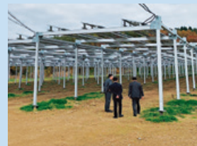
一関市鈴ヶ沢太陽光発電所
