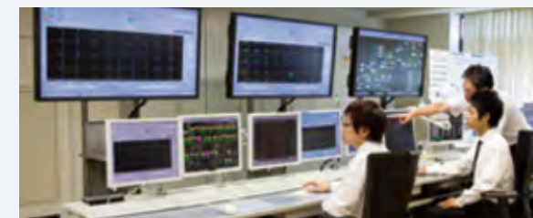
長岡送ガス監視センター
