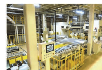
北上ハイテックペーパー (株) 生産設備
