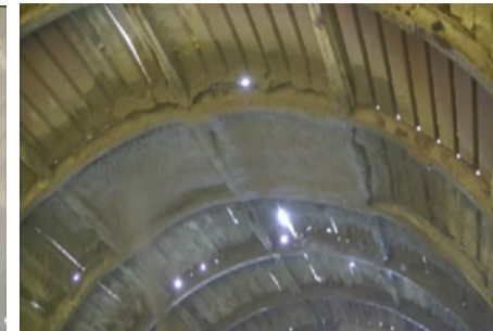
トンネル内：使用時
