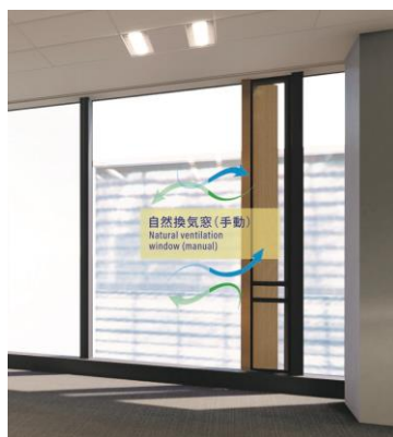
各オフィスフロアに 自然換気窓を導入
