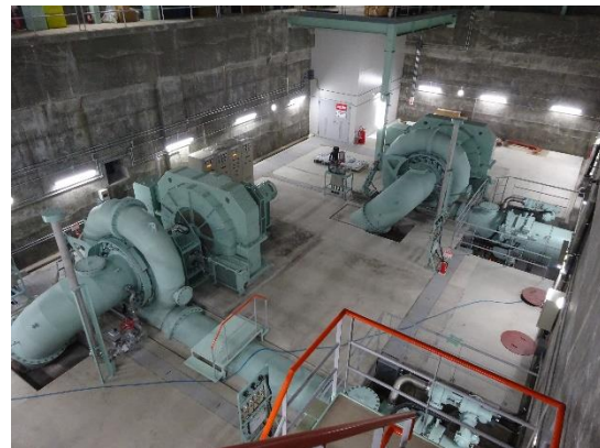
所内（1・2号機水車発電機）
