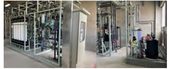
冷却塔ブロー水の回収設備
