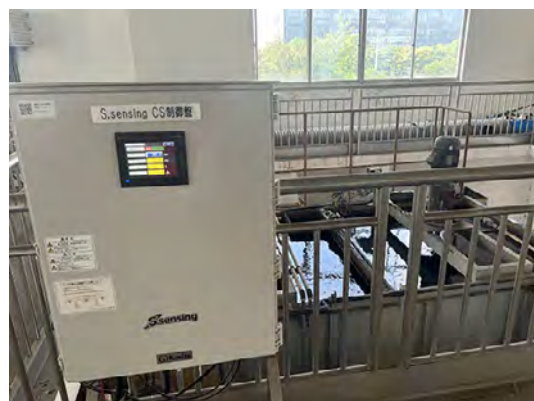
水処理薬品の自動制御システム
