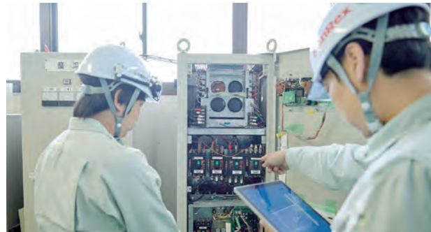
電源機器の保守・点検サービス
