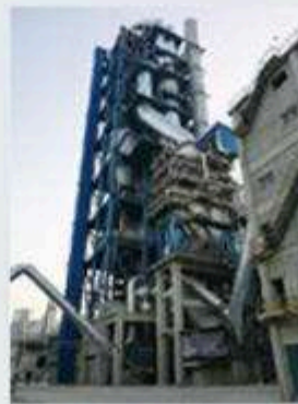
セメントプラント 排熱発電設備
