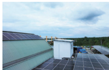
キューピーマレーシア事業所内に設置した太陽光パネルの一部
