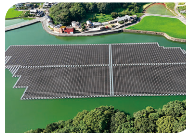
二ツ池太陽光発電所（香川県）
