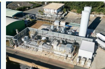
岡山工場 LNGサテライト設備 外観
