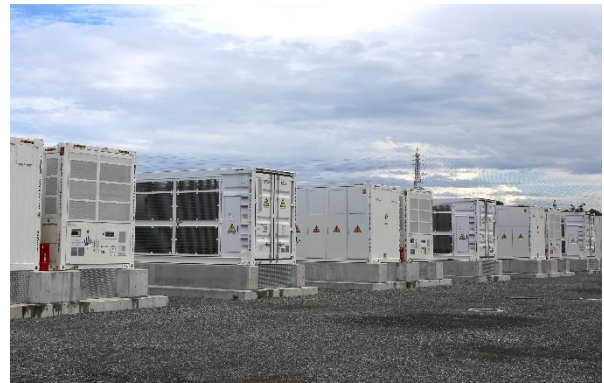
静岡菊川蓄電所
